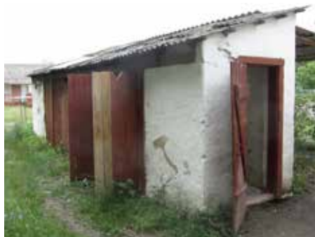
Schultoiletten vor Neubau
